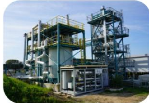
Réchauffeur électrique à sels fondus, Evora
