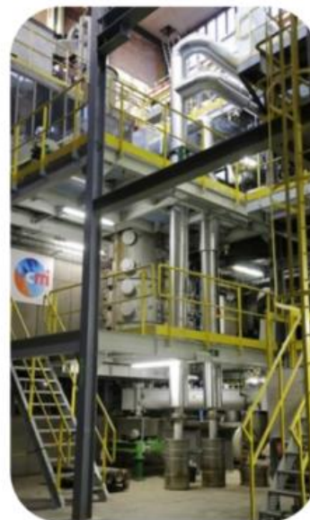
Revalorisation de chaleur fatale avec stockage solide, four industriel
