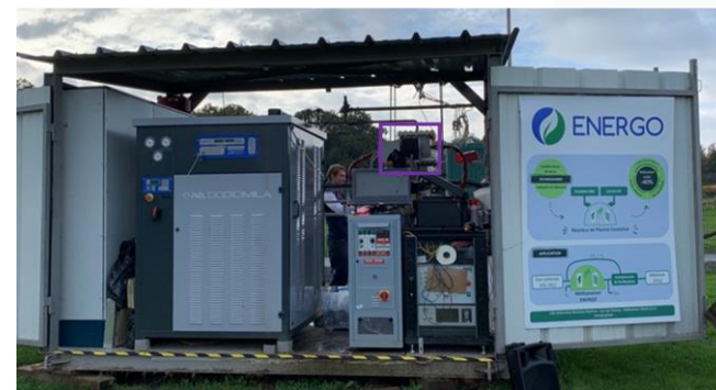
Exemple d'un pilote de power-to-gas sur une unité de méthanisation
