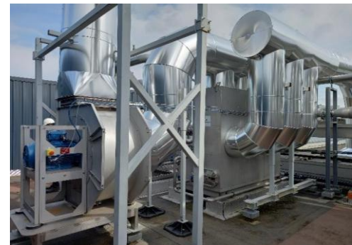
1 des 2 laveurs condenseurs Terrao
