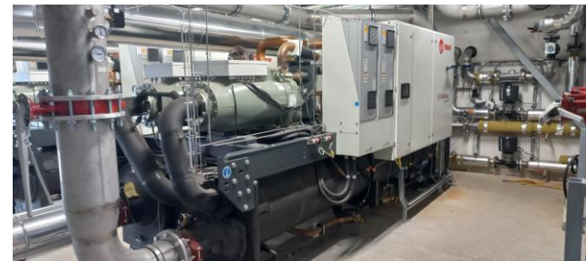
1 des 3 thermo-frigo pompes Trane
