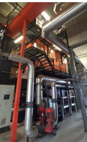
1 des 2 chaudières Weiss – 5 MW
